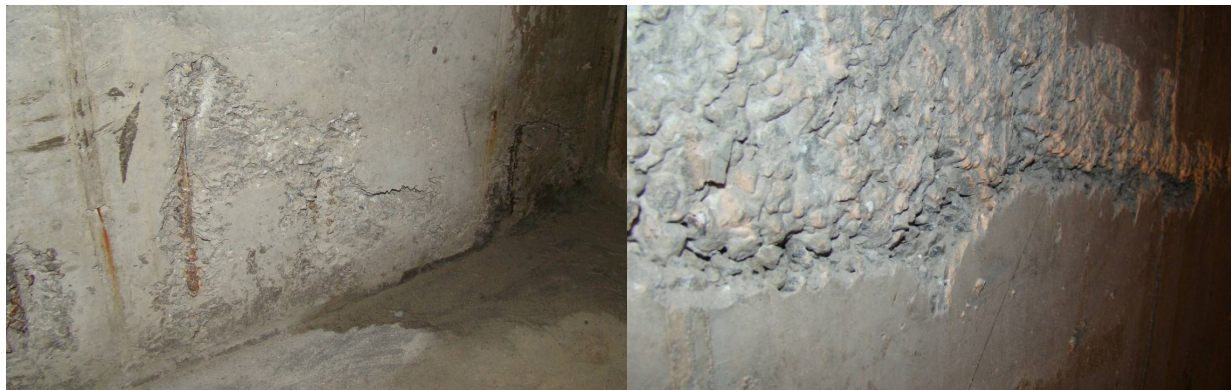
Рис. 1. Характерные дефекты стен железобетонного резервуара
