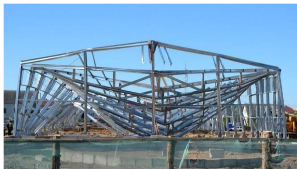
Рис. 1. Разрушение металлических конструкций ангара
