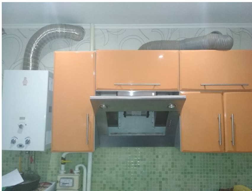
Рис. 1. Расположение газового водонагревателя и кухонной вытяжки (гофрированный трубопровод вытяжки отсоединен от вентиляционного канала для осмотра)
