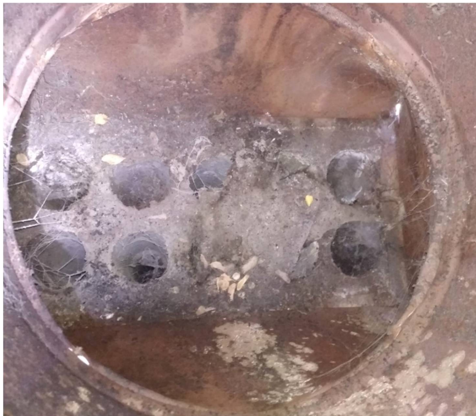
Рис. 4. Строительный мусор на выходах вентиляционных шахт
