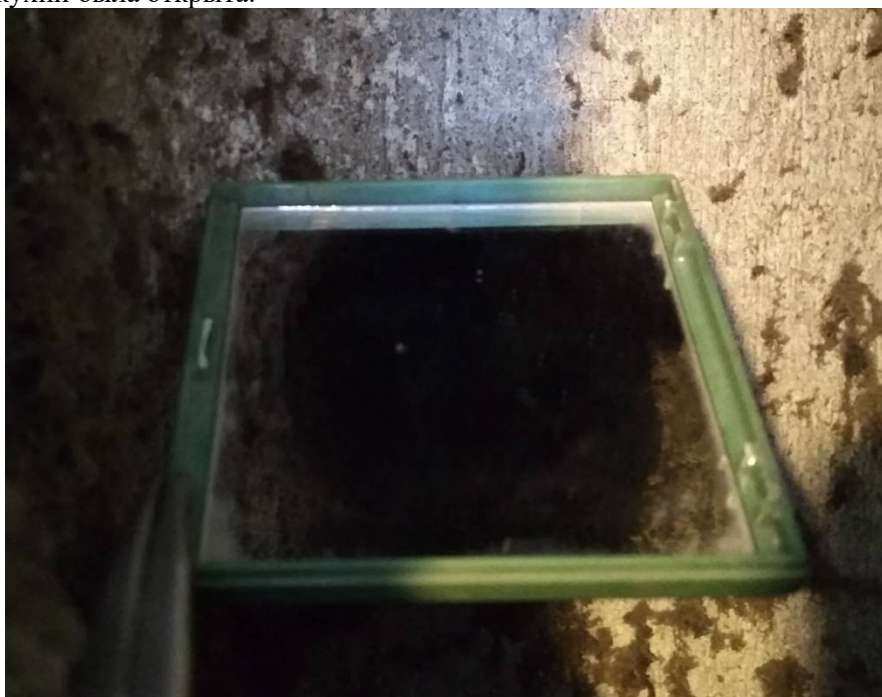
Рис. 2. Видимый свет в вентиляционном канале кухни
