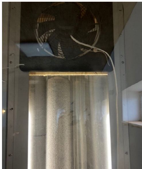
Рис. 2. Наружный блок теплонасосной установки с трубами и утеплителем (один стержень показан без трубы)
