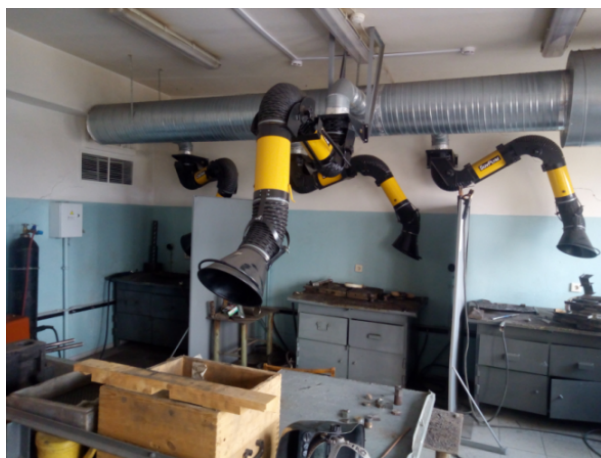
Рис. 1. Электросварочное помещение учебной мастерской
